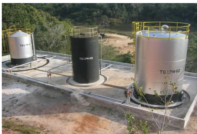
Imagem 1 - Tanques de armazenamento da Estação Lagoa de Paulo Norte
