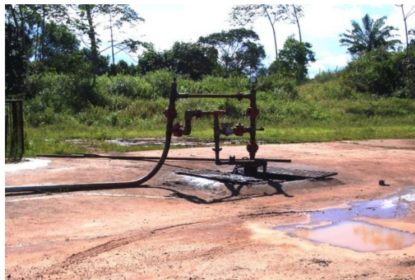
Imagem 9 - Poço equipado com Bomba Eletro Submergível
