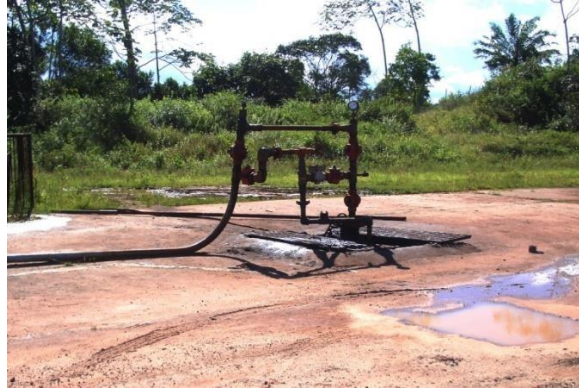
Imagem 9 - Poço equipado com Bomba Eletro Submergível
