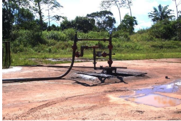
Imagem 9 - Poço equipado com Bomba Eletro Submergível
