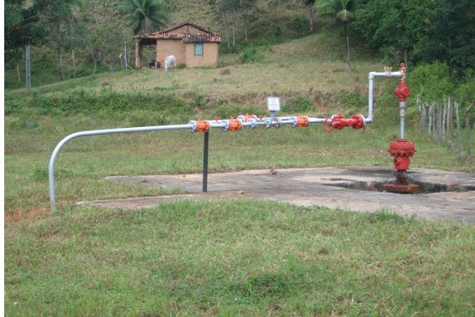
Poço de Injeção de Água no Campo de Gomo
