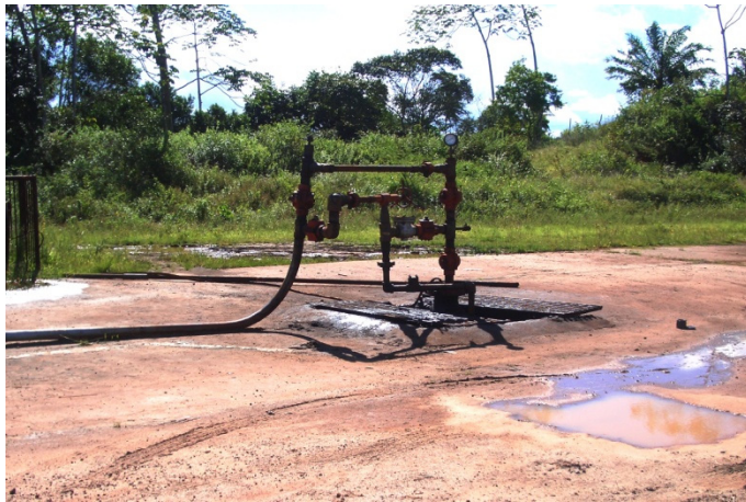
Poço equipado com Bomba Eletro Submersível
