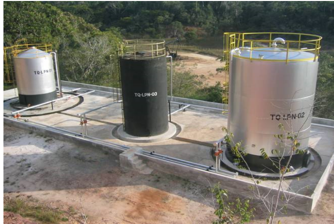
Tanques de armazenamento da Estação Lagoa de Paulo Norte
