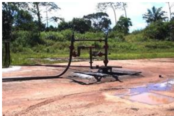
Imagem 9 - Poço equipado com Bomba Eletro Submersível
