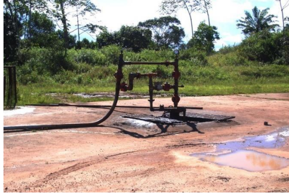
Imagem 9 - Poço equipado com Bomba Eletro Submersível
